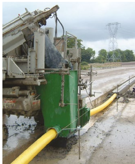
Сегментированный водосток в Узбекистане с накачанной газом трубой.
